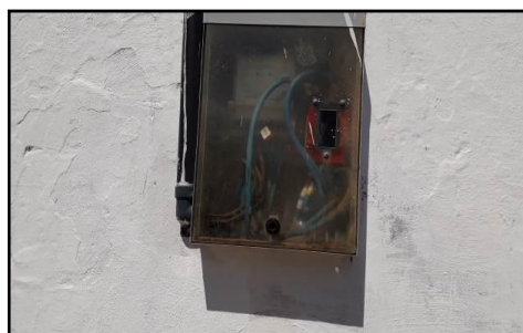
Do poste ao medidor trifásico BT-
