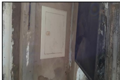
Do medidor ao Quadro de
