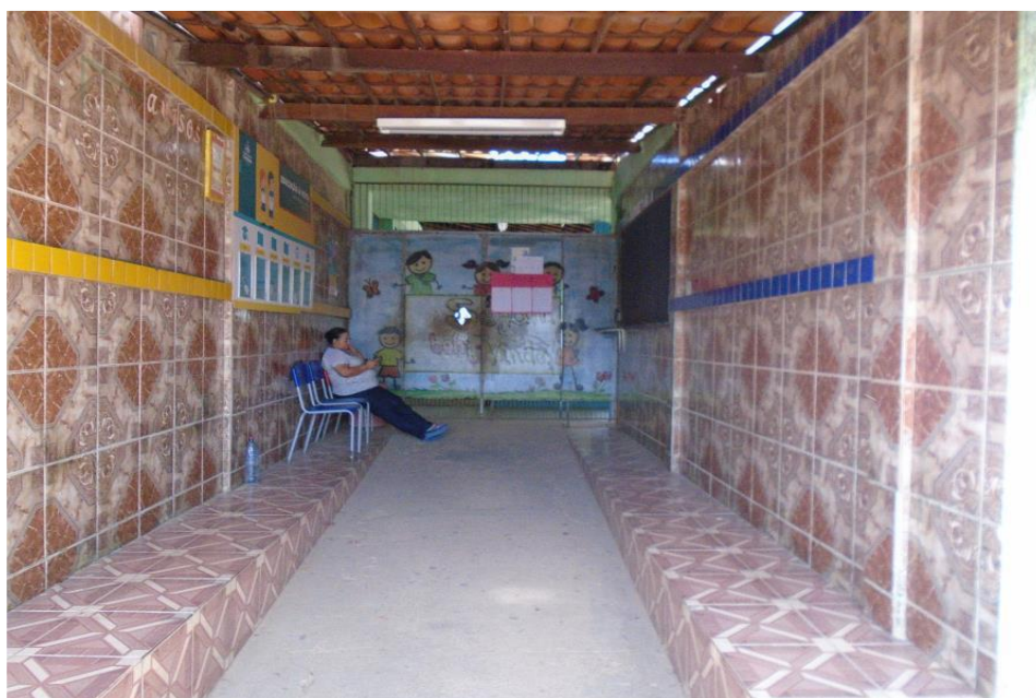
Figura 3 - Foto tirada in loco do desnível para entrada da área interna da escola. Fonte: COPROJ- SEINF.
