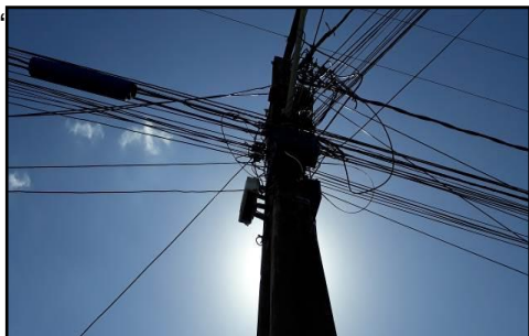
Poste de derivação do ramal
