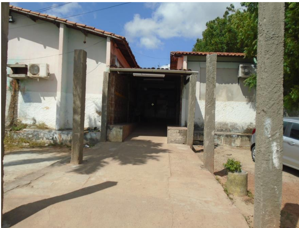
Figura 2 - Foto tirada in loco do desnível que dá acesso à recepção da escola. Fonte: COPROJ- SEINF.
