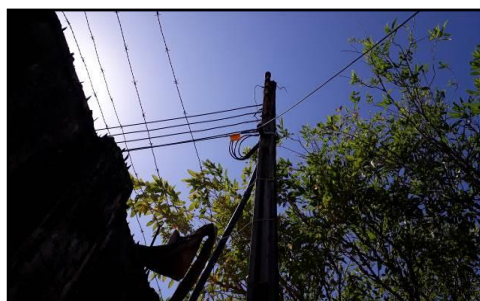
Entrada do ramal em poste 9/300
